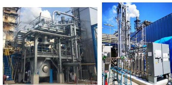
図 バイオエタノールおよびSAF製造装置のパイロットプラント (川崎研究所)
